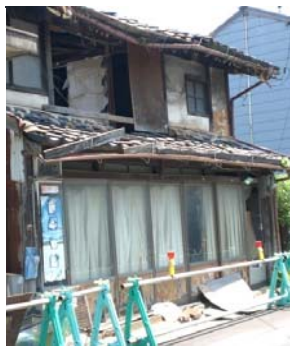
景観形成地区にある廃屋(灘町1丁目)
